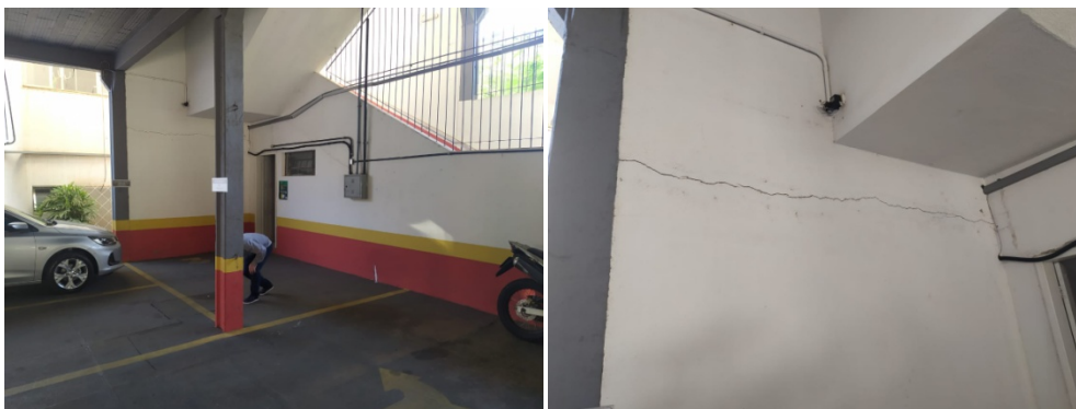
Figura 3 Fissura na área externa.
