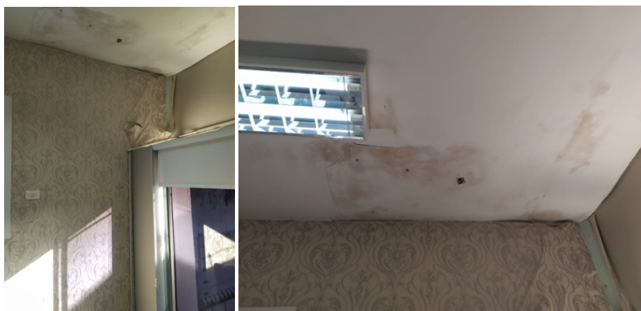
Figura 2 Patologias internas da edificação.
