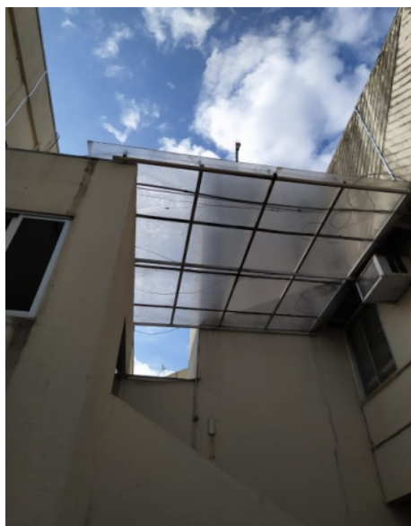
Figura 4 Telha a ser substituída Fonte: Arquivo do autor, 2021.
