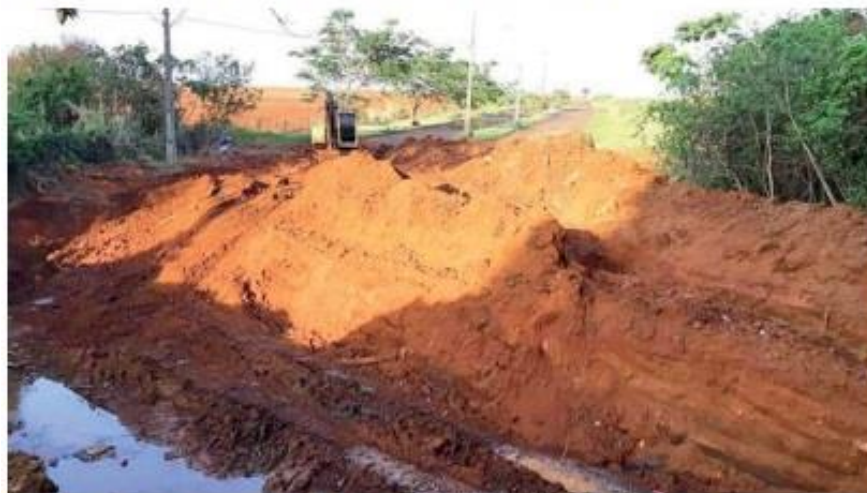
Polícia Ambiental embargou construção de ponte sobre o Rio Almada por falta de documentação
