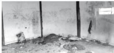
No interior, usuários de drogas utilizam o local também para dormirem
