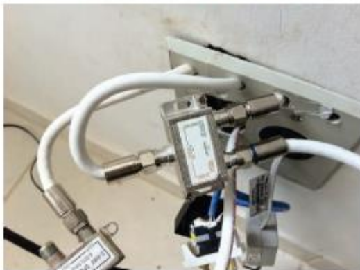
O acúmulo de cabos e de fios inativos impede a instalação de novos serviços
