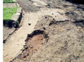
Situação é crítica em diversos locais tanto nos bairros quanto no centro
