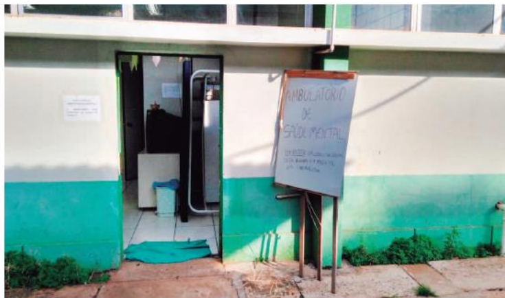
Falta de manutenção das instalações físicas do CEM na Avenida Paraná prejudica o atendimento
