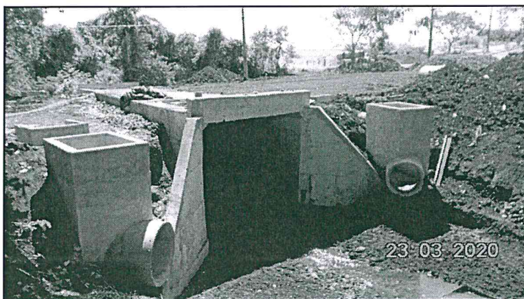
Figura 8 - Saída das CLPs com tubo de DN 1000mm.
