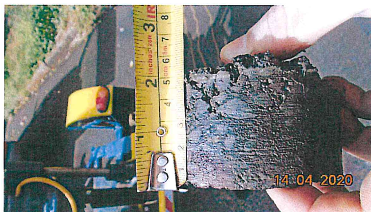
Figura 12 – Corpo de prova nº 11 - Rua Palometa (Reperfilamento e capa)
