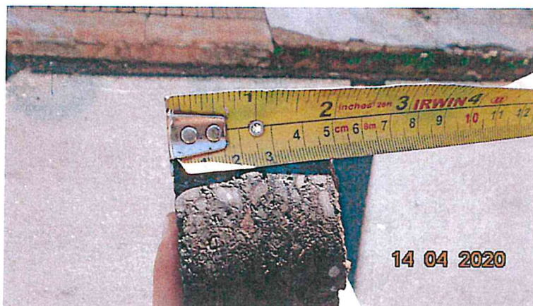
Figura 16 – Corpo de prova nº 15 - Rua Ametista
