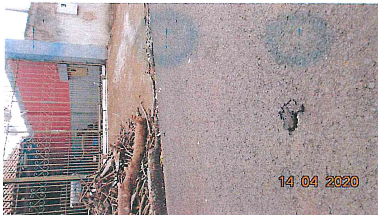
Figura 1 – Material betuminoso desprendido
