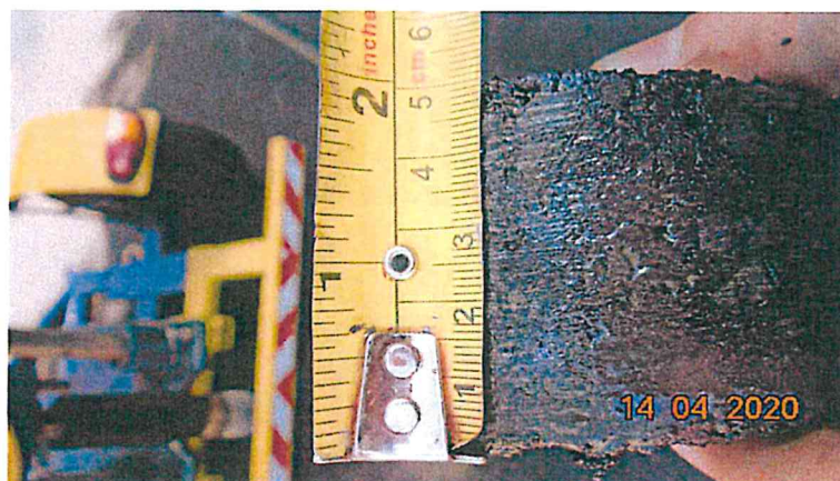
Figura 15 – Corpo de prova nº 14 - Rua Ametista
